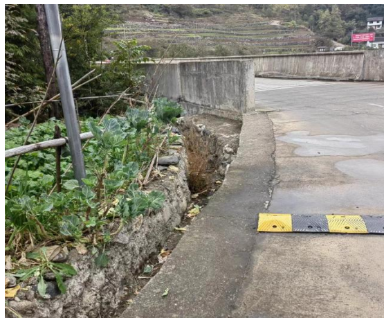
项目路面径流收集沟渠
