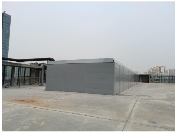
项目中央空调隔声屏障
