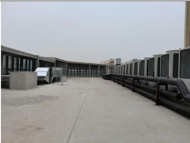
项目裙楼中央空调风机及排风口
