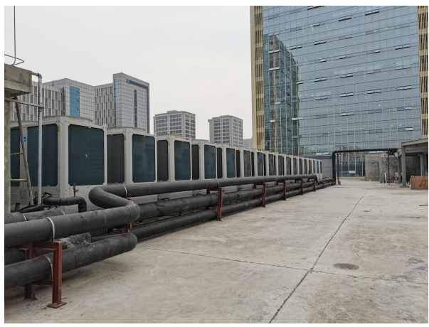
项目中央空调机组
