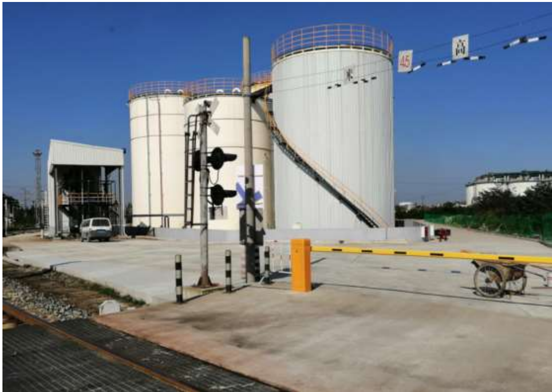
油罐区、计量间
