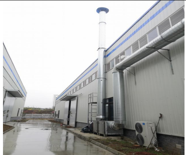
双级活性炭吸附装置及排气筒
